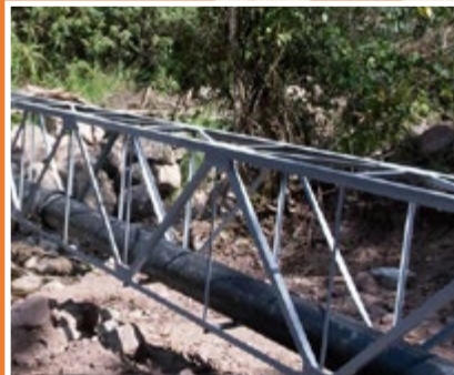
Conducciones en Estructuras
